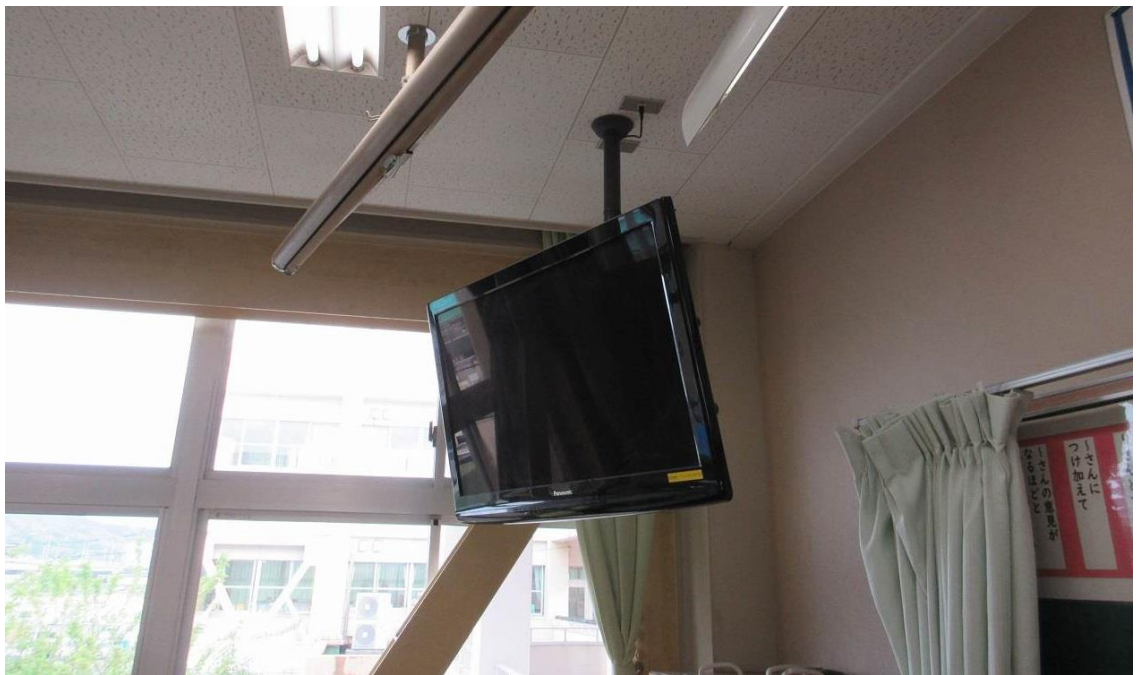
小学校に設置した大型提示装置
