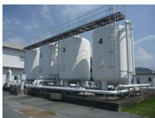
⑥活性炭処理タンク
