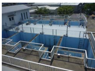
⑤急速ろ過池
